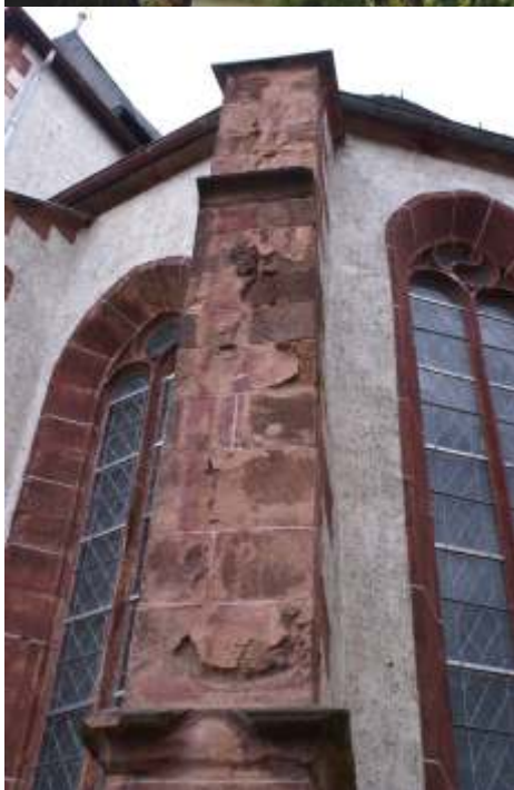
Stark verwitterter Porphyr am Choranbau, Mai 2012
